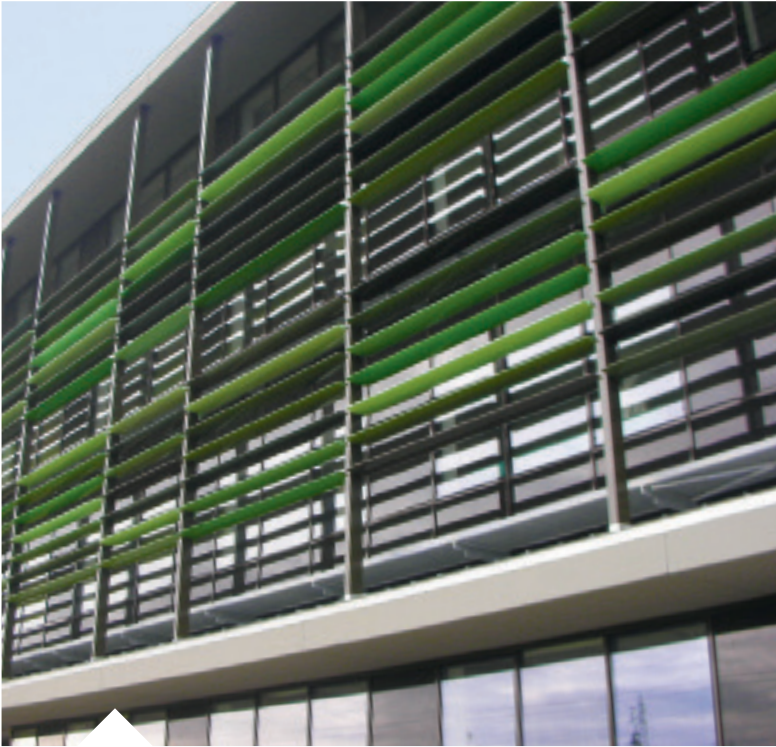
Macif, NIORT (79) Architect: Agence Architecte Associés | Installation: Goyer
