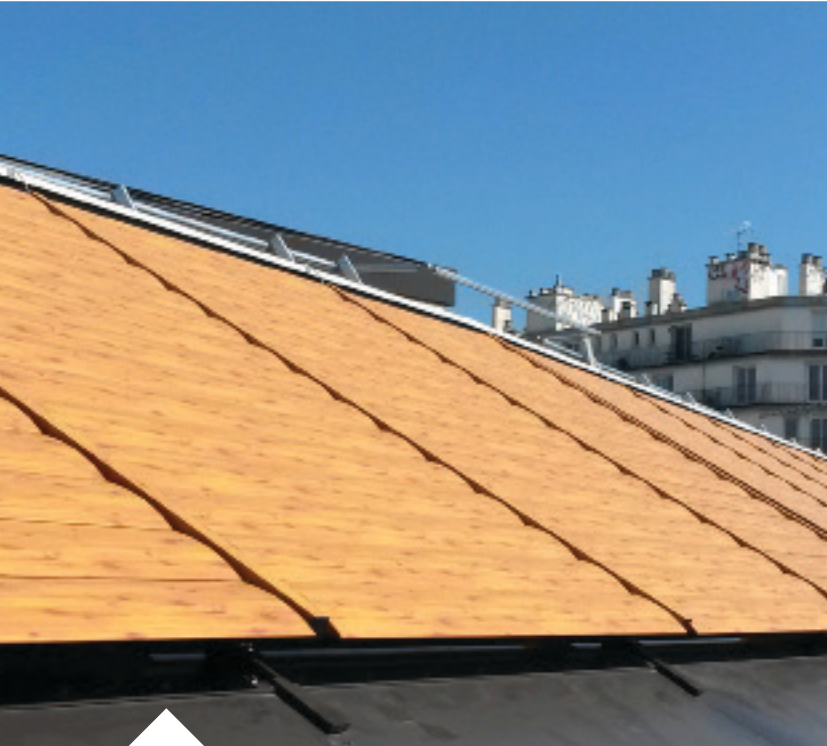
Foundation Abbé Pierre, PARIS (75) Installation: Verrière du nord
