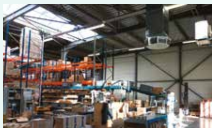
Figure 3.6 - Les systèmes de ventilation adiabatique assure une ventilation permanente efficace et une fonction de rafraîchissement à très faible coût global.
